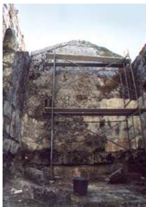
Aspeto da parede fundeira da capela-mor durante a primeira fase de intervenção.
